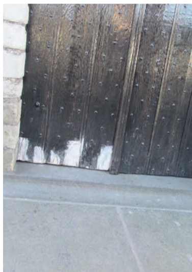
Niet alleen regulier schilderwerk maar ook waar nodig deelvervanging van aangetast houtwerk
