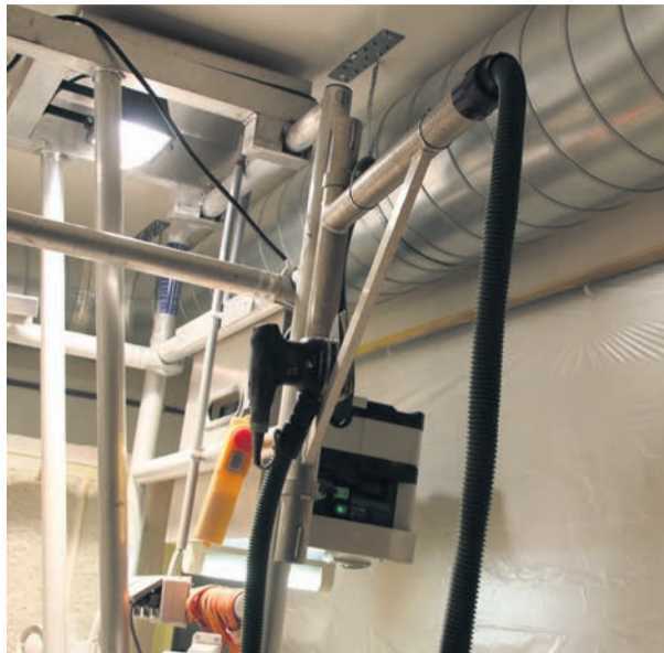
De stofzuiger op een plateau aan de rijdende bok, met de slang via een beweegbaar stuk steigerpijp
