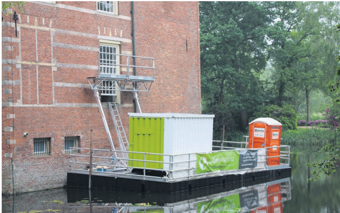
Waar en hoe komt de steiger te staan? Deze omstandigheden vertalen zich naar een x-aantal uren op een offerte
