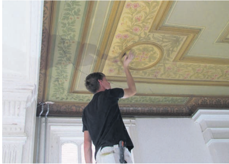
De reiniging van de plafondschildering in de voorkamer. Daarna volgt het uitrepareren van de scheuren. Retouches zullen ervoor zorgen dat de schades onzichtbaar zijn
