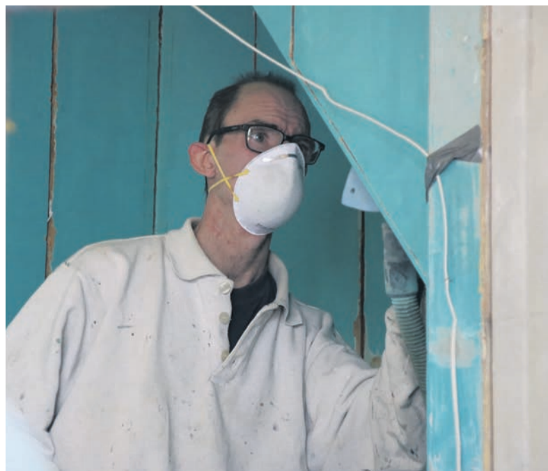
Ferrie Baatje aan het schuren. Het bedrijf fungeert als hoofdaannemer voor stukadoor en timmerman, maar doet klein timmerwerk ook zelf
